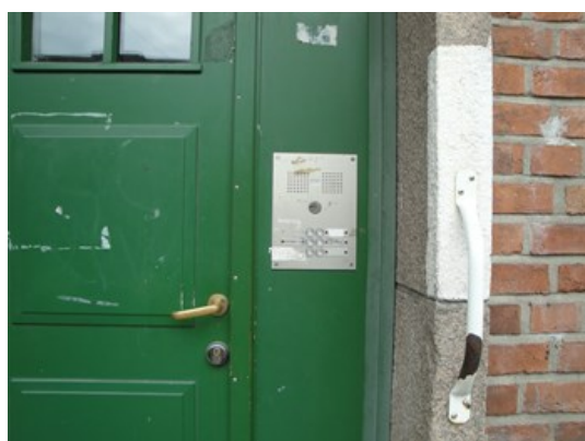
Bilde viser porttelefonanlegg.
