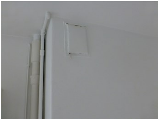
Ventil på kjøkken
