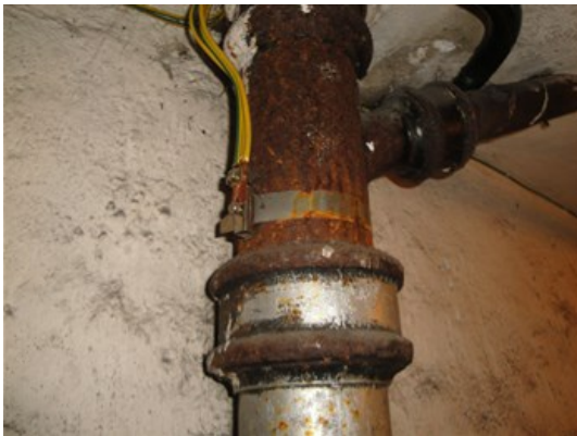
Bilde viser soilrør som har utjåmningsforbindelse (jording)
