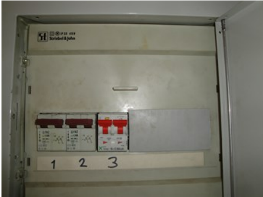
Bilde viser et sikringsskap med få kurser.
