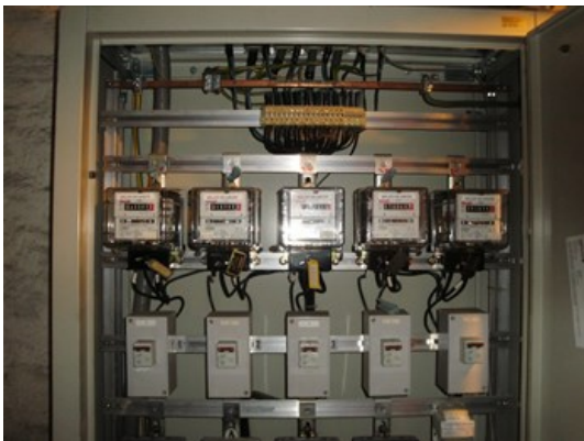
Bilde viser deler av en oppgradert hovedtavle.
